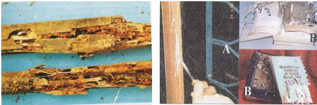
Gambar 24. Kerusakan akibat serangan rayap pada struktur bangunan dan isinya (A) dan buku (B)
